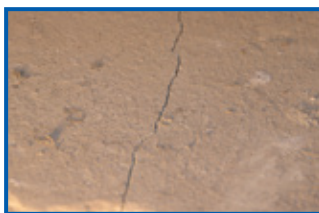
Стяжка с трещинами
