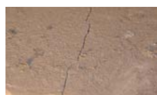
Стяжка с трещинами
