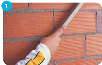
1 Стены здания требуют выравнивания.
